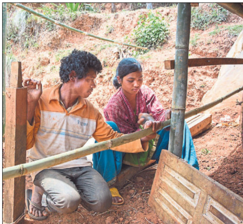
Provisorisch baut sich ein Paar einen Unterstand. Bei dem Erdbeben wurden fast 200 Häuser in dem Dorf zerstört.
